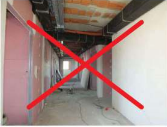
İskele Kurulmaya Uygun Olmayan Zemin
